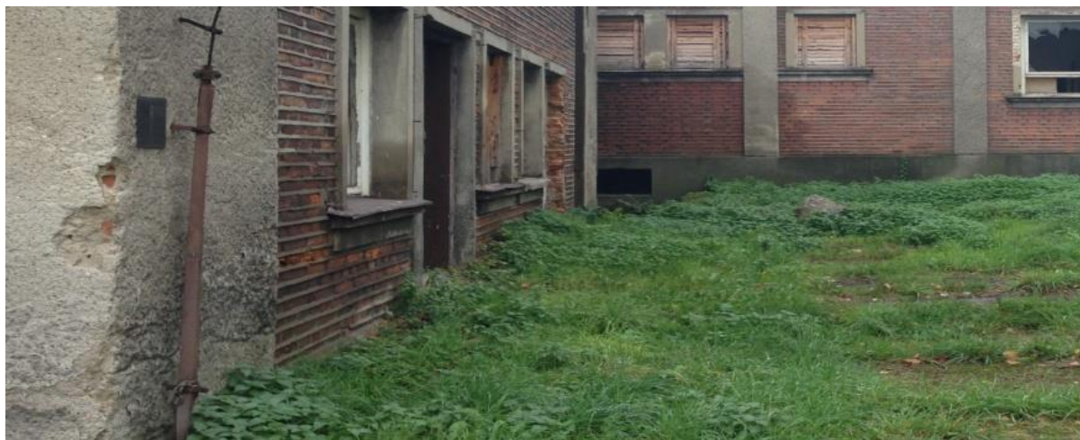
Obrázek 5 detail zdi zasažených plísní (zdroj vlastní)
