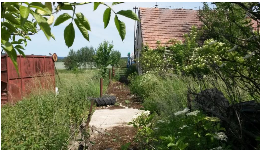
Obrázek 4: Stav vnějších ploch a betonových ramp objektu
